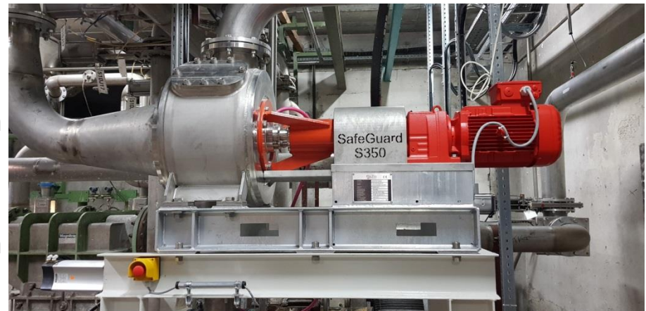
Installation in einer Papierfabrik
